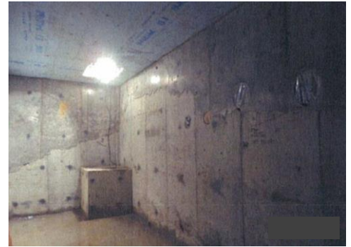
校舎地下に設置した雨水貯留槽の内部
