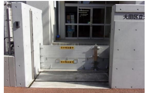
通用門に設置した止水板
