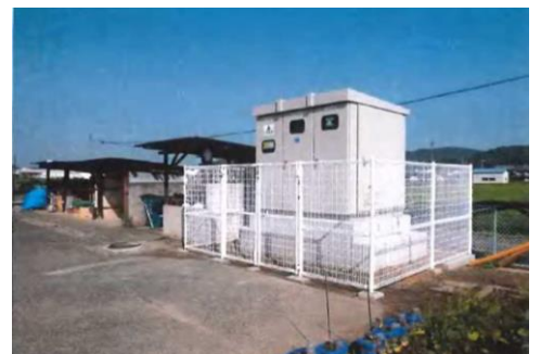
設置面を嵩上げた キュービクル式高圧受電設備
