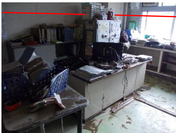
被災時の1階職員室 赤線：浸水高さ
