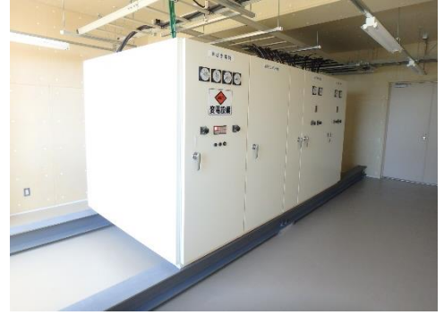
移設後の受変電設備
