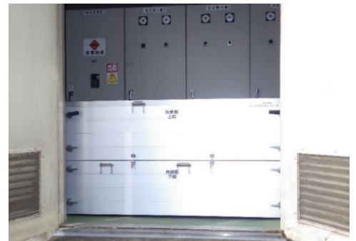
電気室内に設置した止水板
