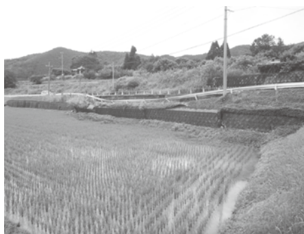
市道大河内線復旧前
