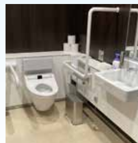
サニタリーボックスが設置してある本庁舎の多目的トイレ
