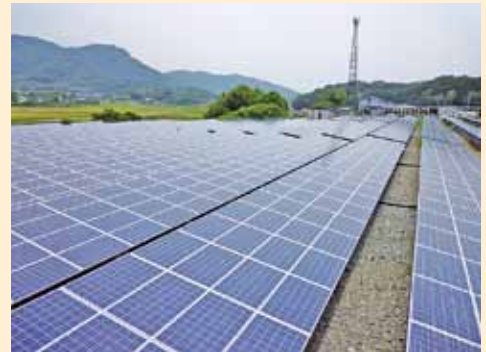
太陽光発電施設
