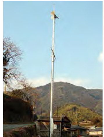
各地区に設置する屋外放送設備
