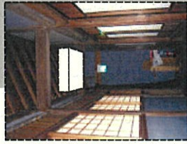
廊下 (天吊形空調機)
