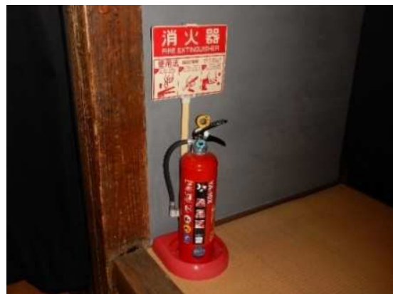
写真 4 - 16 消火器設置状況 (義務設置)
