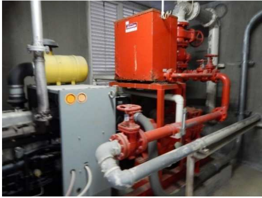
写真 4 - 17 ポンプ小屋内部の 動力消防ポンプ（任意設置）
