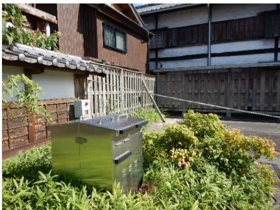
写真 4 - 21 北側、交通広場（駐車） 放水銃設置状況（任意設置）
