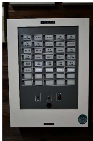
写真4-7 仕出シ場（東売店） 火災受信機（義務設置）
