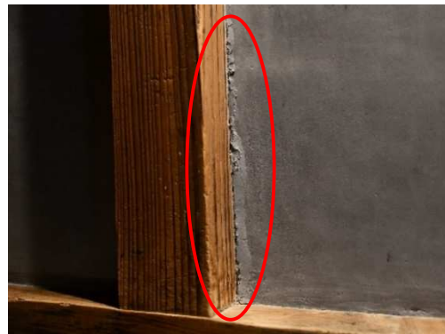
写真 4 - 26 八千代座内部漆喰壁の被害
