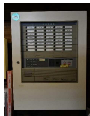
写真4-10 八千代座管理資料館 「夢小蔵」火災受信機 （義務設置）
