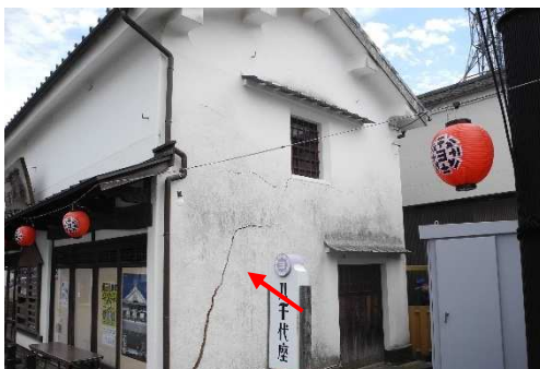
写真 4 - 27 「夢小蔵」外部漆喰壁の剥離
