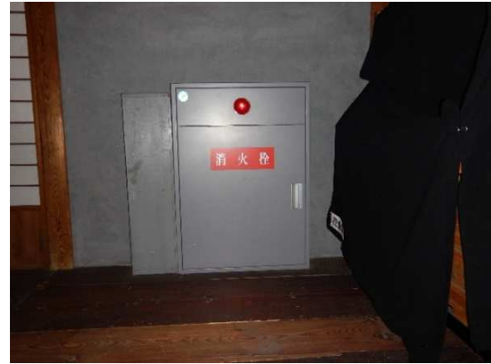
写真 4 - 12 上手側、舞台袖の屋内消火栓 (努力義務)
