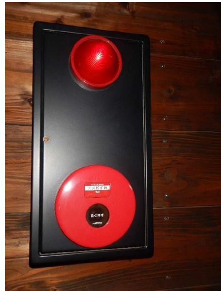
写真 4 - 14 舞台裏の火災警報機 (義務設置)
