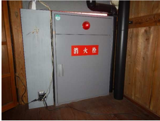
写真 4 - 11 下手側、舞台袖の屋内消火栓 (努力義務)
