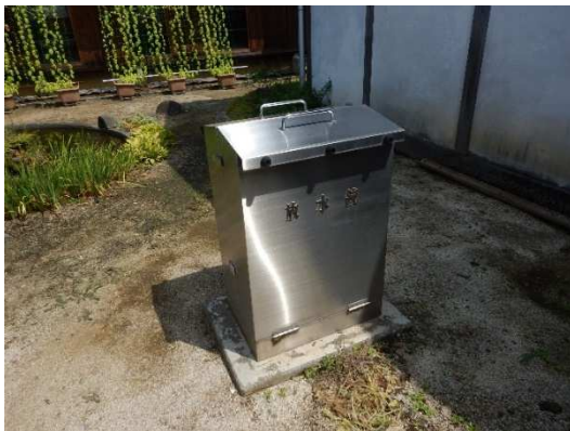
写真 4 - 19 東中庭の放水銃設置状況 （任意設置）
