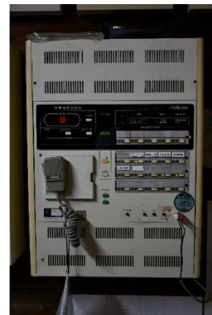
写真4-8 仕出シ場（東売店） 非常用放送設備（任意設置）
