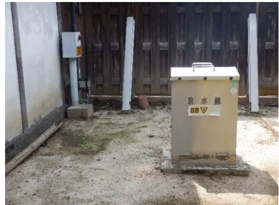
写真 4 - 20 西中庭の放水銃設置状況 左後方に起動釦（任意設置）
