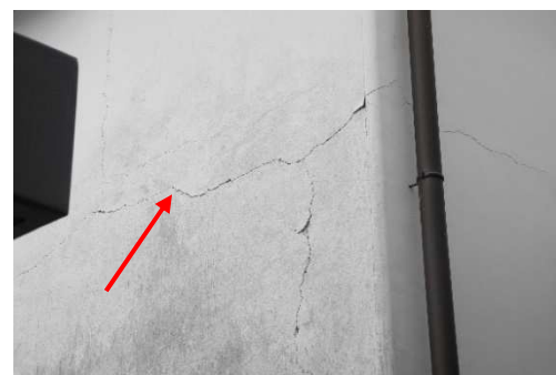
写真 4 - 28 「夢小蔵」外部漆喰壁の亀裂
