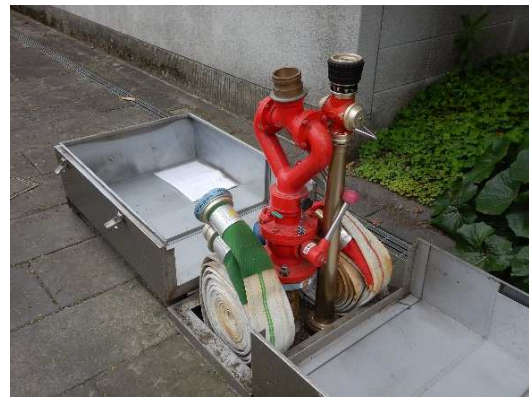
写真 4 - 18 南側、木戸前の放水銃 （収納箱を開けた状態）（任意設置）
