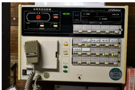
写真4-9 八千代座管理資料館 「夢小蔵」非常用放送設備 （任意設置）
