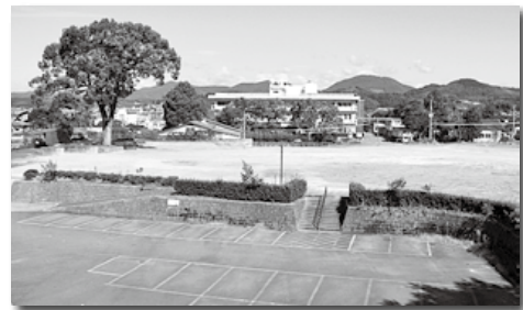
▲建設予定地の既存施設(旧中央公民館、旧勤労青少年ホーム)の解体が終わりました。
