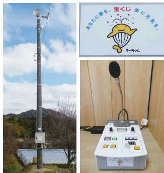
▲区内放送を行う放送設備
