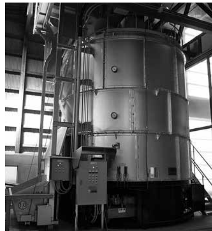
生ごみ堆肥化施設
