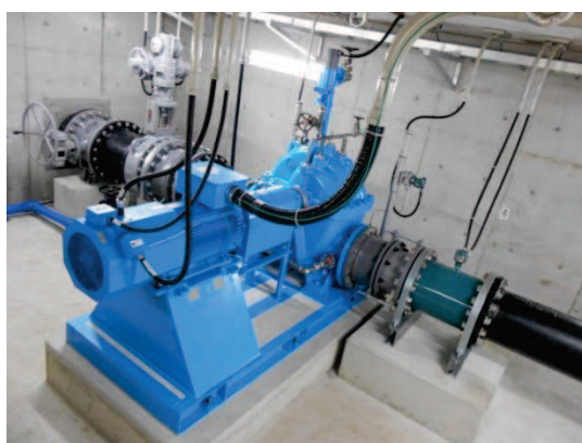
小水力発電（戸島送水場）
