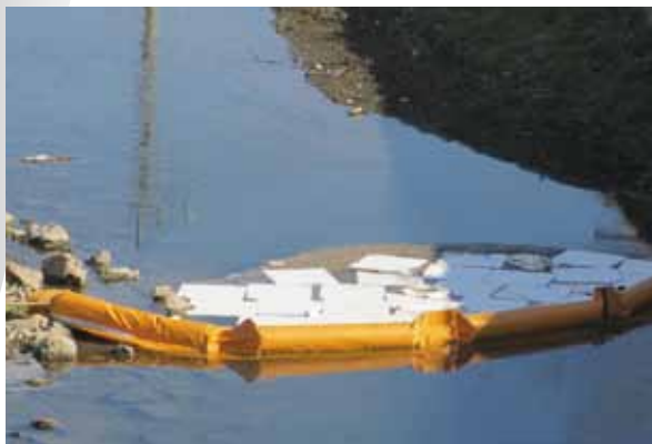
油が河川に流出したため、オイルフェンスと吸着マットを設置した様子
