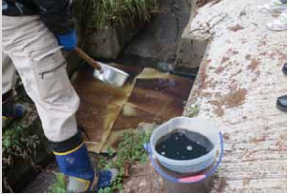
用水路に流出した油を手作業で回収している様子
