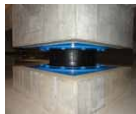
庁舎を支える免震装置
