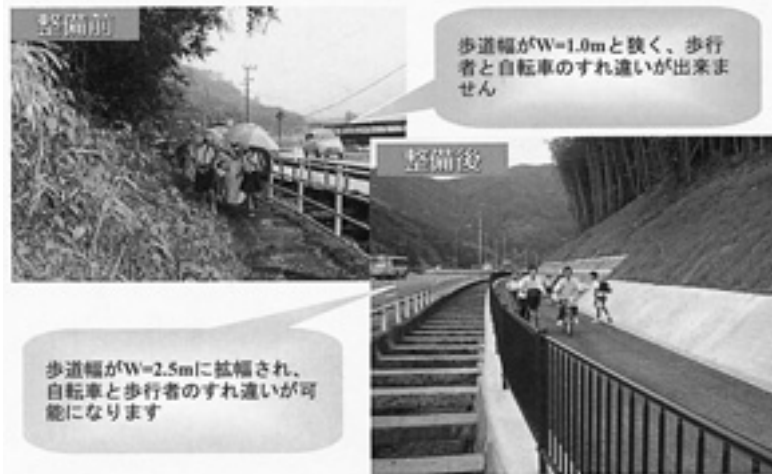
▲国道3号沿い三岳小前から小坂橋手前までの歩道を整備しています
