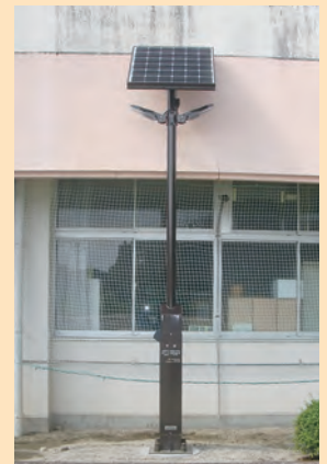
米野岳中に設置された防災ソーラー照明灯
