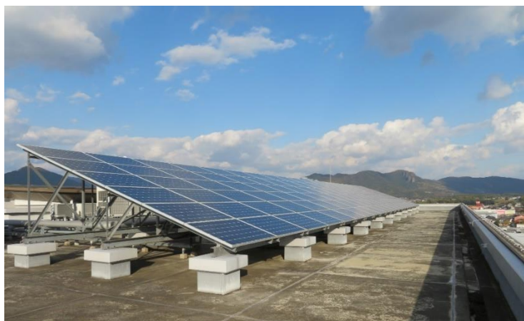
■ 市役所庁舎屋上の太陽光発電設備
